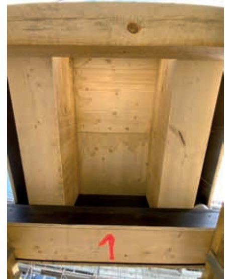
Abbildung 6: Durchfeuchtete Bereich an Modell 1
