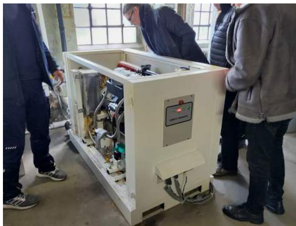
Mini-Kraftwerk bei ÖTEC © Dipl.-Ing- Bernd Pachheiser
