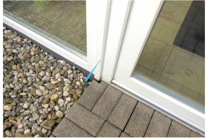
Abb. 4: ... Profile bis auf die Betonplatte ab- und damit in die inneren Hausbereiche geleitet wird.
