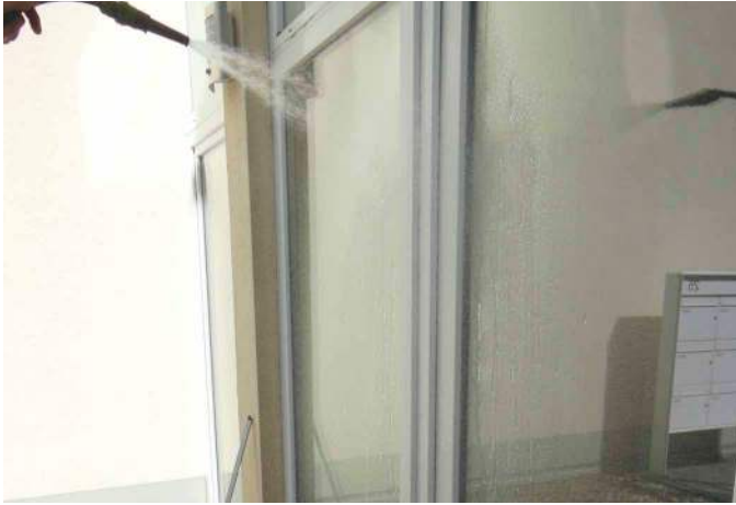
Abb. 3: Wasserversuche zeigten, dass das auf der Fassade auftreffende Schlagregenwasser durch...
