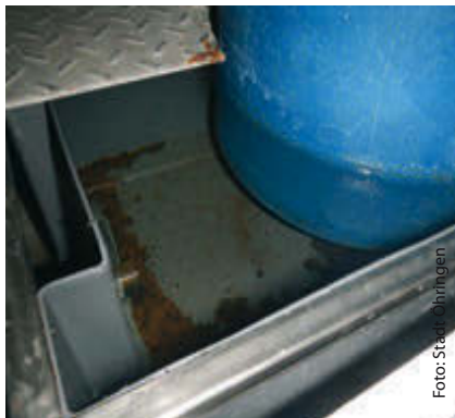
Bild 5: Tauchsiphon am unteren Ende des Übereichs der Wasserbehälter
