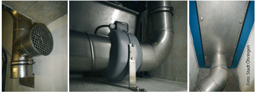
Bilder 2 + 3 + 4 Einlassöffnungen der Lüftungsanlage, Lüfter und Auslass durch Wand
