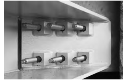
Das Bild zeigt die Verbundankerschrauben Foto: Prof. Feix Ingenieure GmbH
