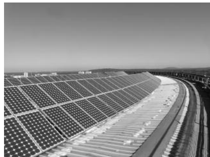
Photovoltaikanlage in luftiger Höhe Foto: Hochbauamt der Stadt Nürnberg
