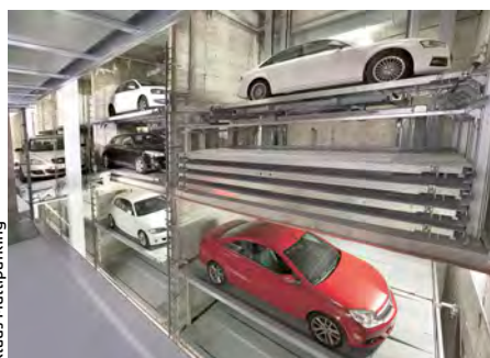
Der „MasterVario R3C“ von Klaus Multiparking verteilt die Fahrzeuge vollautomatisch innerhalb kürzester Zeit auf die insgesamt 85 Plätze.
